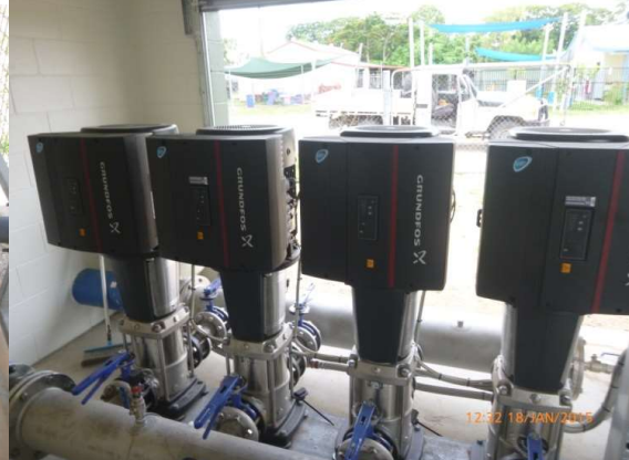
Grundfos Booster Pumps
